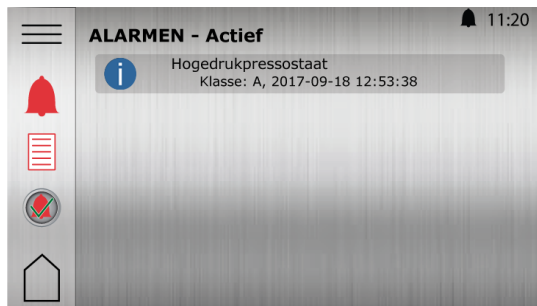
Fig. 2: Voorbeeld van alarmen
